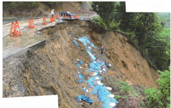
写真-1 道路崩落状況
