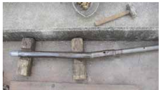
接続部の破損
